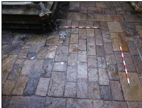
Vista del paviment UE 2 en el tram afectat per la cala
