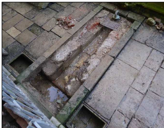
Vista del conducte de sortida de l'aigua de la bassa. A la part inferior s'observa l'inici de la canalització perpendicular
